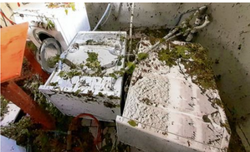
So wie in dieser Waschküche eines Gebäudes im Füssener Westen drang in viele Keller Wasser ein – und hier auch jede Menge Blattwerk. Das Wasser stand über einen Meter hoch und warf Waschmaschinen um.
