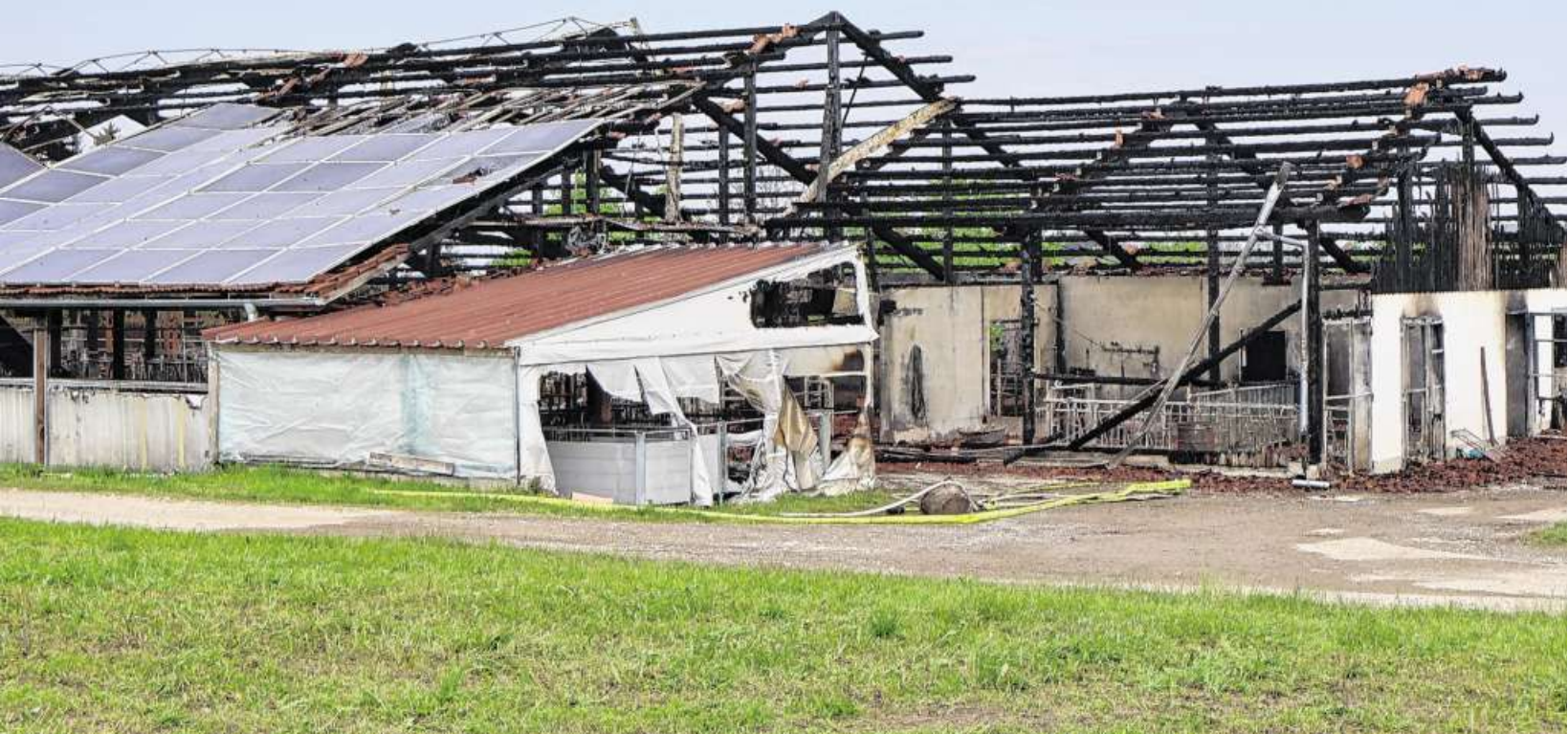
Auf dem Dach des Stalls in Untrasried war eine Photovoltaik-Anlage montiert. Obwohl diese Anlagen die Brandbekämpfung für die Feuerwehren erschweren, geht grundsätzlich keine erhöhte Brandgefahr von sogenannten PV-Anlagen durch einen Defekt aus. Foto: Stefanie Gronostay
